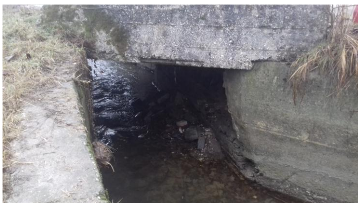
Ponte di via Olmeo prima dei lavori scatolari (si noti il parziale crollo della spalla)
