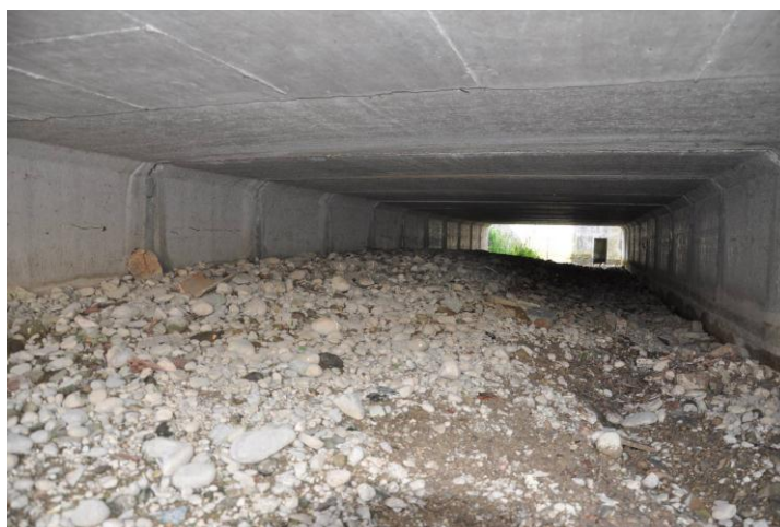
Il ponte parzialmente ostruito dalle ghiaie, prima dei lavori
