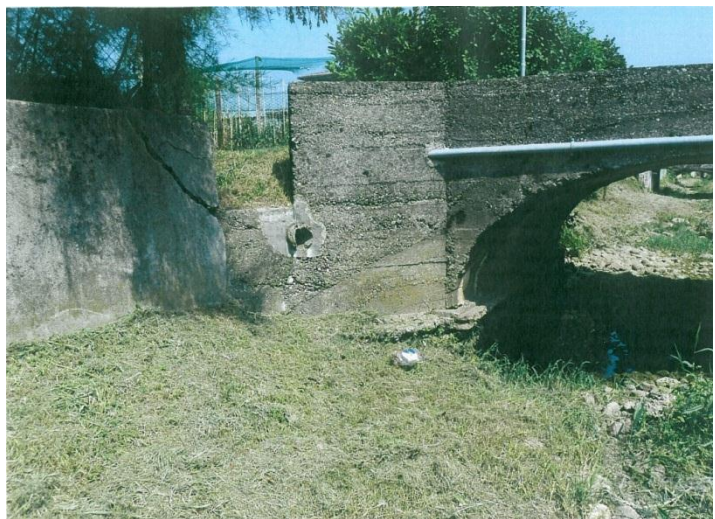
Stato dei luoghi prima dell'intervento: si notano la sezione ristretta del ponte ed i fenomeni erosivi sotto di esso
