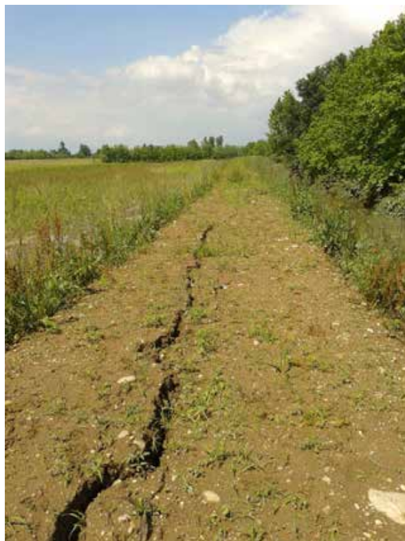
Stato dell'argine prima dei lavori. Si nota la fessura che si era creata in sommità, testimonianza di un pericoloso fenomeno franoso
